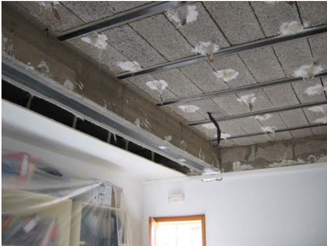
Fig. 17. Refuerzo de viguetas con fisuración.
