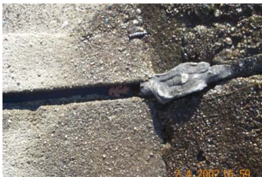
Ejemplo típico de fallo del sellado por la utilización de un material inadecuado y una aplicación poco cuidada.
