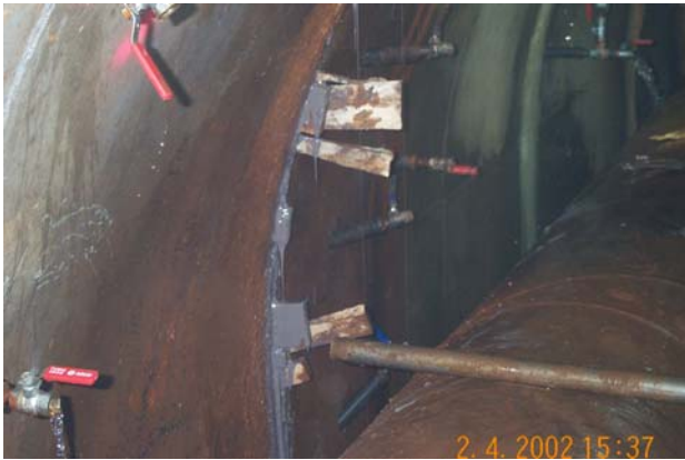
Inyección de las juntas de la galería de la presa de Sta Lucía. (Ávila. Tragsa)
