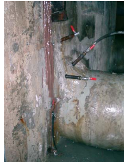
Sellado de filtraciones en un pasamuros. Oceanográfico de Valencia.
